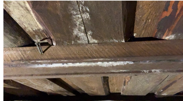
Hvit overflatesopp på treverk.
