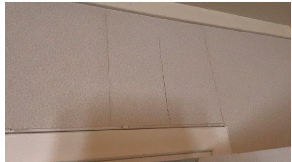
Eksempel på sprekk i overflate.
