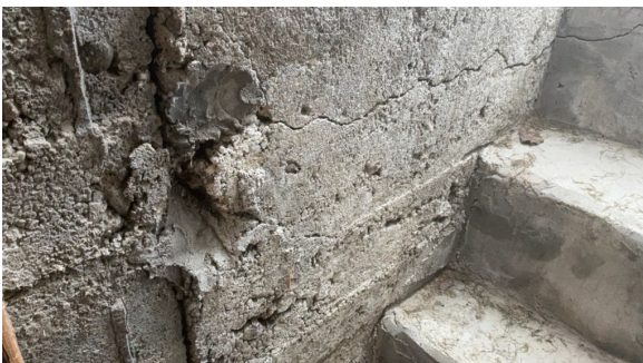
Sprekk i vegg på kjellernedgang.
