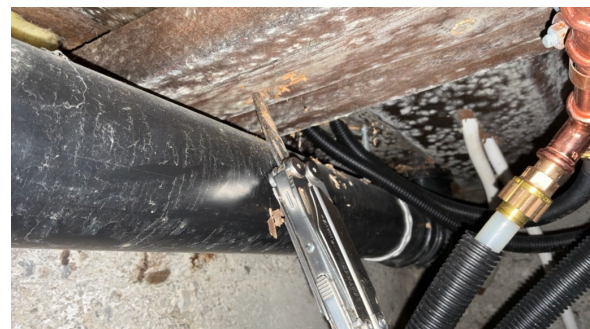
Begynnende råte i sperre
