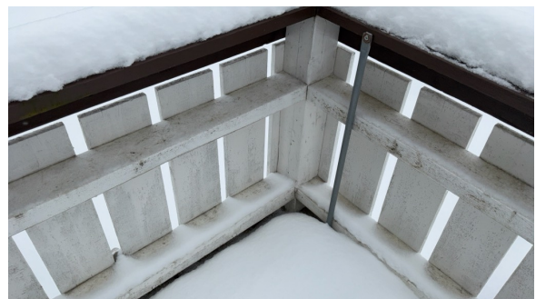
Eksempel på slitasje/misfarging på hovedveranda.
