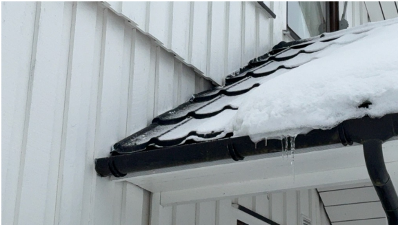
Det er ikke tett overgang mellom tak og vegg på veranda mot øst.
