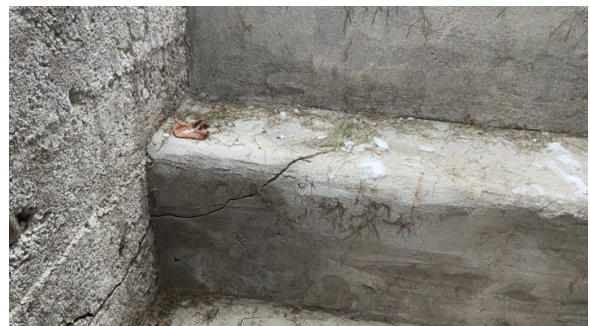
Sprekk i trapp på kjellernedgang.
