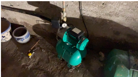
Vanninntak med stoppekran i kjeller.
