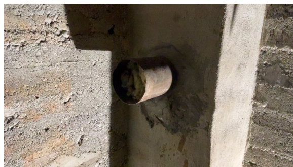
Åpent røykrør i kjeller.
