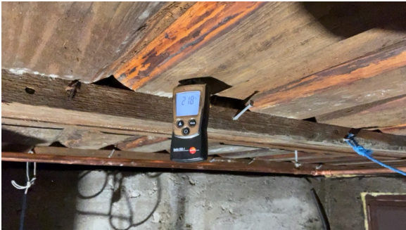
Fukttinnhold i treverk på over 20 vektprosent.
