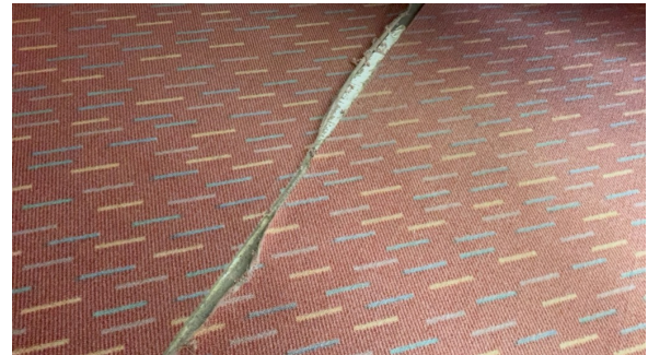
Teppe løsner i skjøt.
