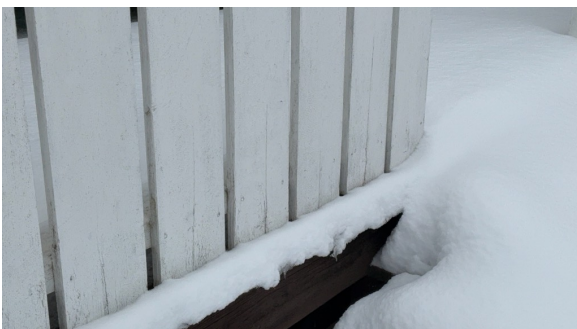
Eksempel på sprekker i kleddningsbord på hovedveranda.
