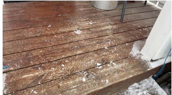
Eksempel på slitasje på veranda mot øst.
