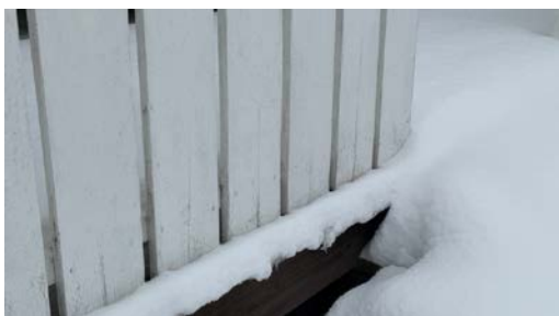
Eksempel på sprekker i kleddningsbord på hovedveranda.
