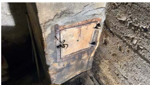
Sotluke i kjeller.
