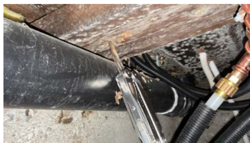
Begynnende råte i sperre
