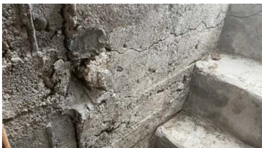
Sprekk i vegg på kjellernedgang.
