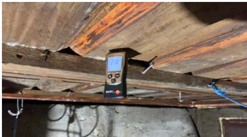
Fukttinnhold i treverk på over 20 vektprosent.
