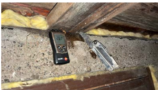
Begynnende råte i sperre og fukttinnhold i treverk på ca. 28 vektprosent.
