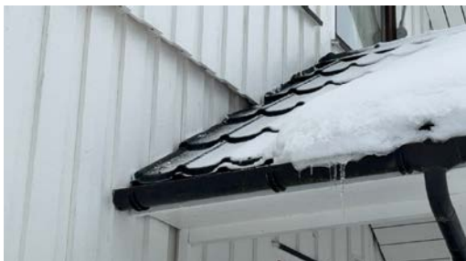
Det er ikke tett overgang mellom tak og vegg på veranda mot øst.
