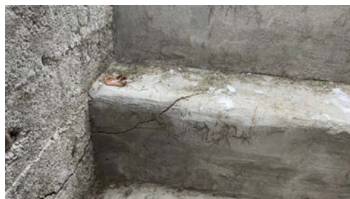
Sprekk i trapp på kjellernedgang.
