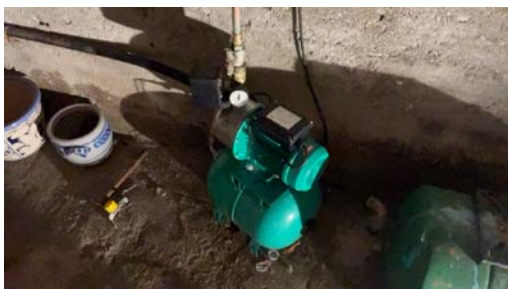
Vanninntak med stoppekran i kjeller.
