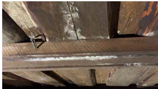
Hvit overflatesopp på treverk.
