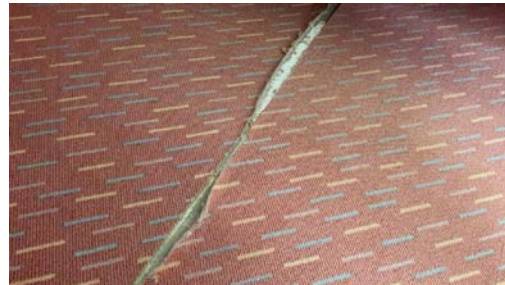
Teppe løsner i skjøt.
