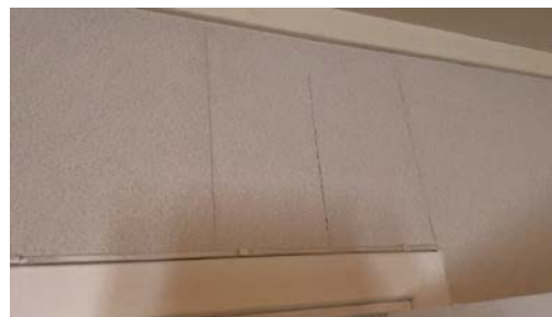
Eksempel på sprekk i overflate.
