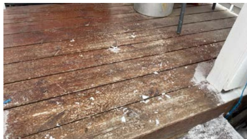
Eksempel på slitasje på veranda mot øst.
