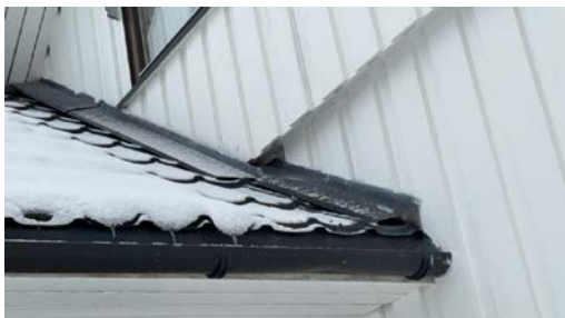
Beslag ligger utenpå kledning og har begynt å løsne.
