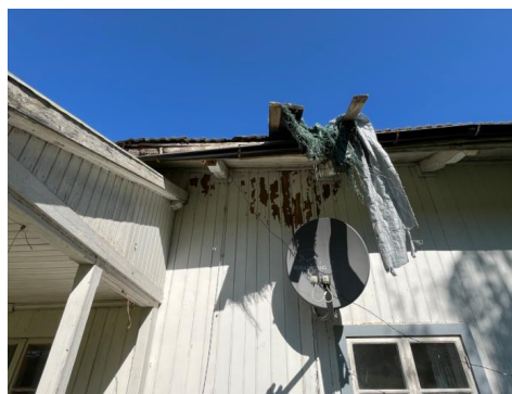
Deformasjoner på takrenne
