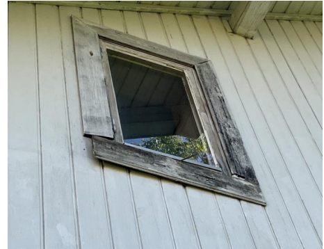
Dårlig tetting rundt vindu
