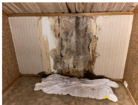
Fuktskader i vegg, gulv og tak
