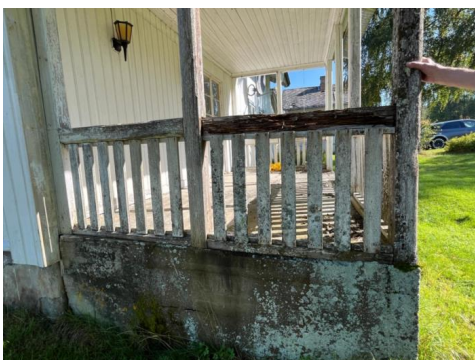
Råteskader i trekonstruksjoner
