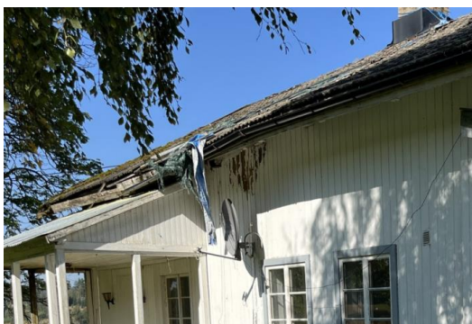
Manglende og ødelagt takstein
