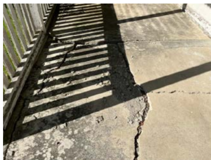
Sprekker i betonggulv
