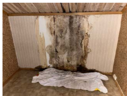
Fuktskader i vegg, gulv og tak
