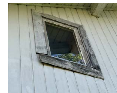
Dårlig tetting rundt vindu
