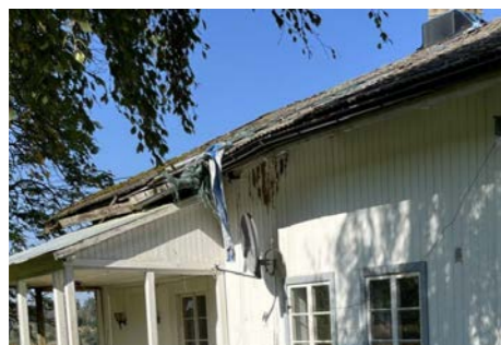
Manglende og ødelagt takstein
