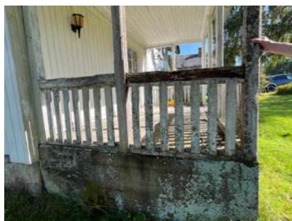
Råteskader i trekonstruksjoner
