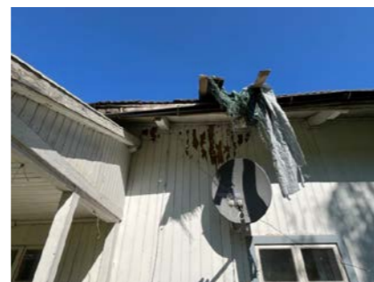
Deformasjoner på takrenne
