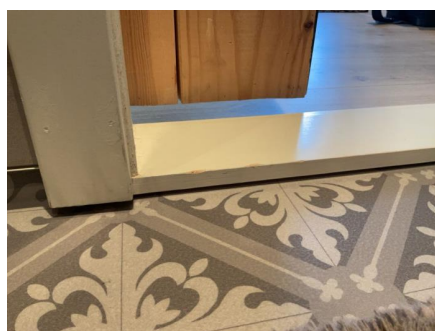
Ingen oppbrett av membran ved terskel.
