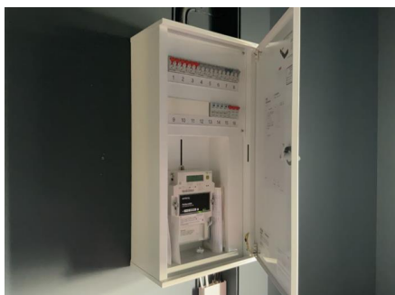
Sikringsskap plassert på soverom.
