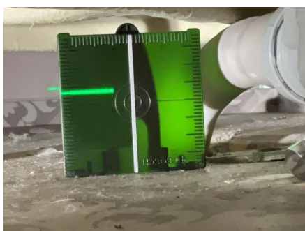
Gulvet er flatt og det er ikke registrert fall til sluk.
