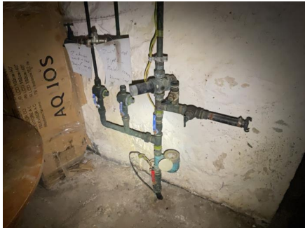
Hovedstoppekran for bygning plassert i kjeller.
