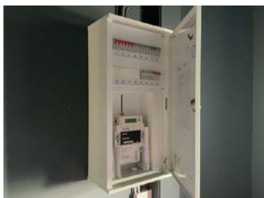
Sikringsskap plassert på soverom.
