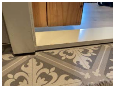
Ingen oppbrett av membran ved terskel.
