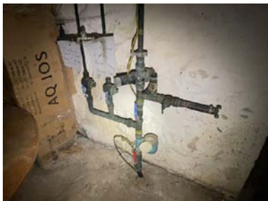
Hovedstoppekran for bygning plassert i kjeller.
