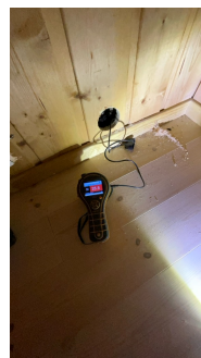
Hulltagning foretatt i gang ved trapp. Fuktmåling ble foretatt, jeg målte skadelig fukt.
