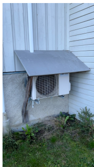
Vann fra varmepumpe må ledes vekk fra grunnmur.
