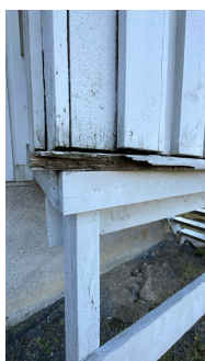
Det er påvist fukt-/råteskader i konstruksjonen.
