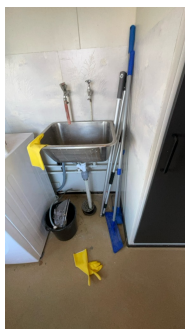
Slitasje på overflater ved utslagsvask.
