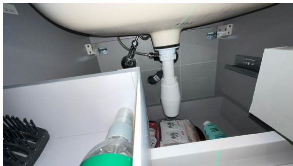
Utett gjennomføring under servant.
