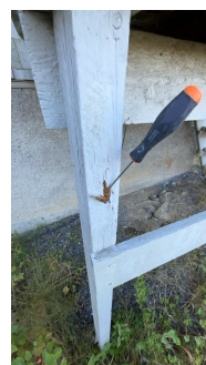
Det er påvist fukt-/råteskader i konstruksjonen.
