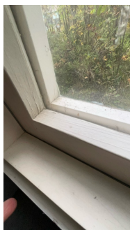
Kondensmerker på enkelte vinduer.
