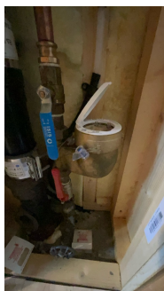
Stoppekran er plassert i underetasje.
