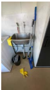
Slitasje på overflater ved utslagsvask.
