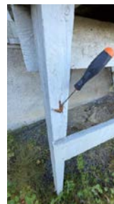
Det er påvist fukt-/råteskader i konstruksjonen.
