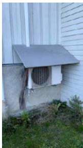
Vann fra varmepumpe må ledes vekk fra grunnmur.
