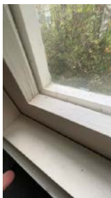
Kondensmerker på enkelte vinduer.
