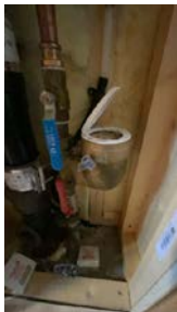
Stoppekran er plassert i underetasje.
