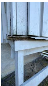
Det er påvist fukt-/råteskader i konstruksjonen.
