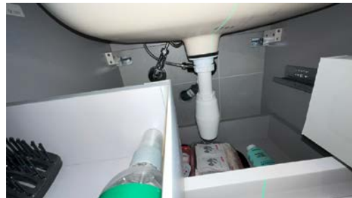
Utett gjennomføring under servant.
