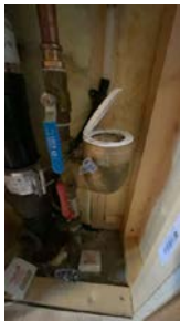
Stoppekran er plassert i underetasje.
