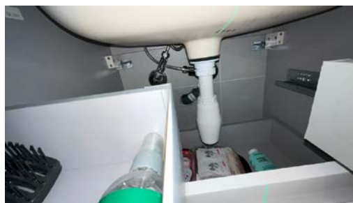
Utett gjennomføring under servant.
