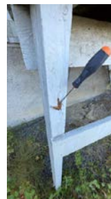
Det er påvist fukt-/råteskader i konstruksjonen.
