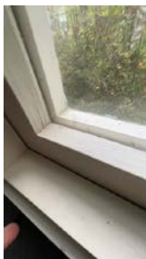
Kondensmerker på enkelte vinduer.
