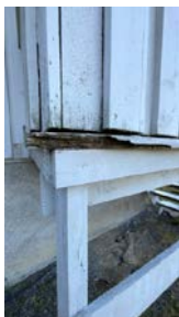
Det er påvist fukt-/råteskader i konstruksjonen.
