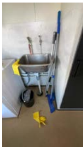
Slitasje på overflater ved utslagsvask.
