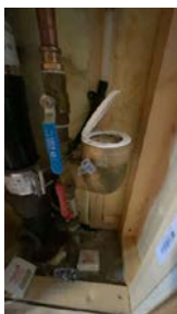
Stoppekran er plassert i underetasje.
