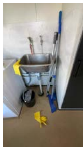
Slitasje på overflater ved utslagsvask.
