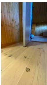
Dør fra entre til kjellerstue tar i gulv.
