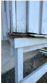
Det er påvist fukt-/råteskader i konstruksjonen.
