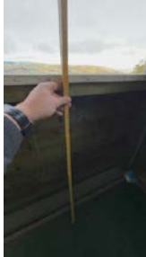
Rekkverket er for lavt i forhold til dagens krav til rekkverkshøyder.
