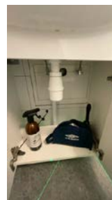
Fordelingskap plassert på bad i kjeller, ikke mulig og åpen på befaringen.
