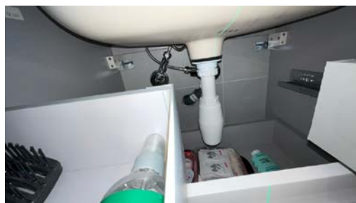
Utett gjennomføring under servant.
