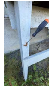
Det er påvist fukt-/råteskader i konstruksjonen.
