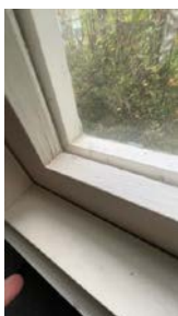
Kondensmerker på enkelte vinduer.
