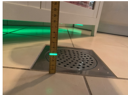
Lite fall på gulv mot sluk
