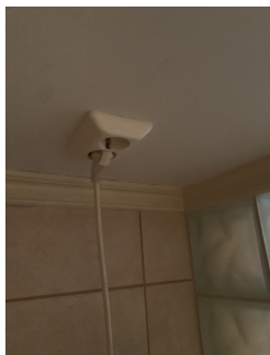
Stikkontakt tilkobling av bereder er ikke forskriftsmessig
