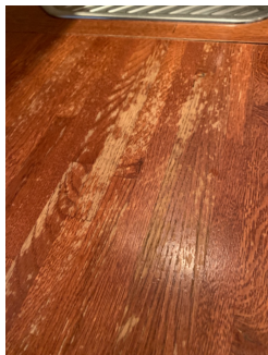
Slitasje på benkeplaten overflatebehandling
