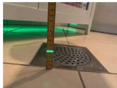
Lite fall på gulv mot sluk
