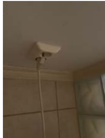
Stikkontakt tilkobling av bereder er ikke forskriftsmessig
