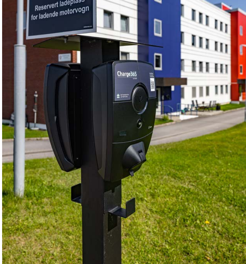
Borettslaget har parkeringsplasser med elbilladere.
