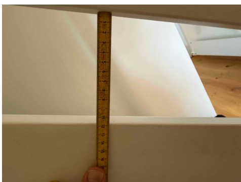
Bildet viser åpning i rekkverk.
