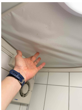
Bildet viser løs folie på himlingsplaten.
