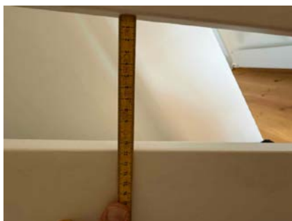
Bildet viser åpning i rekkverk.
