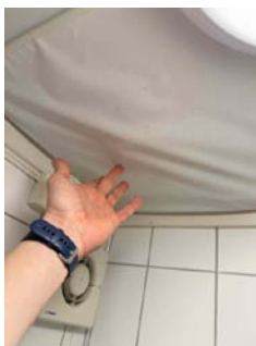
Bildet viser løs folie på himlingsplaten.
