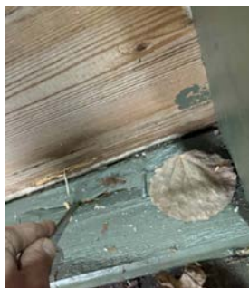
Bildet viser råte i bunnsvill på skuret mot kjøkkenet.
