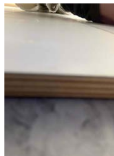
Bildet viser undersiden av baderomsplate uten bunnlist.
