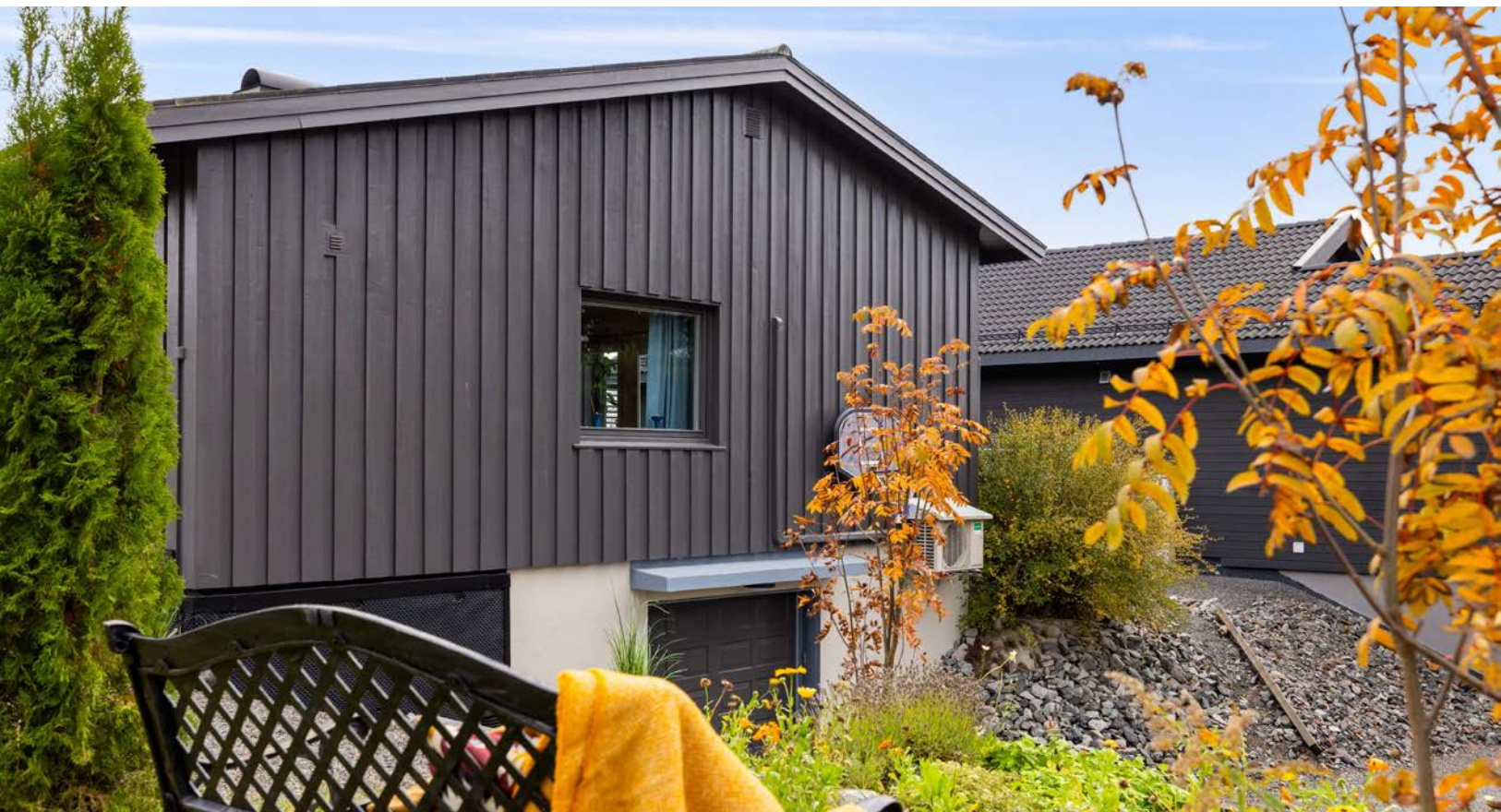
Det er kjøpt inn ytterdør, som er ment skal monteres ved siden av garasjeporten. Ytterdøren står i garasjen. Åpning til dør i betongveggen er ikke utført.
