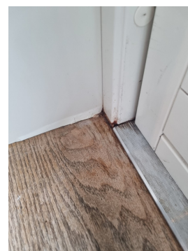
Mindre skade bunn foring balkongdør
