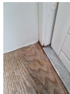
Mindre skade bunn foring balkongdør
