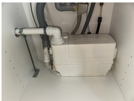
Pumpe for avløp plassert i benkeskap på kjøkken
