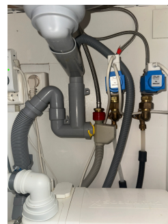
Røropplegg i kjøkkenbenk med Waterguard
