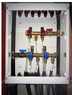
Samleskap med rørkurser og stoppekraner
