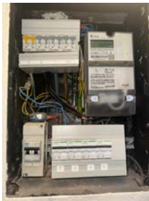
Sikringsskap med automatsikringer.
