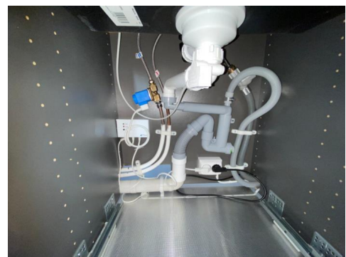
Rørpropp under kjøkkenbenk
