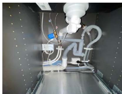
Røropplegg under kjøkkenbenk
