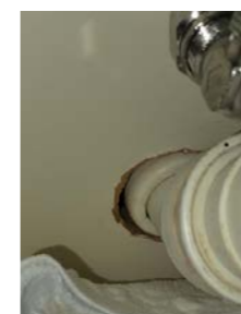
Det er påvist mangelfull/feil utførelse rundt rørgjennomføringer e.l. som gir fare for fukt i konstruksjonen i våtsone.
