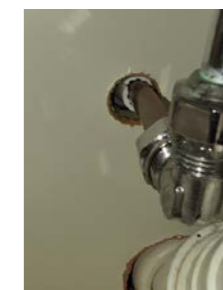
Det er påvist mangelfull/feil utførelse rundt rørgjennomføringer e.l. som gir fare for fukt i konstruksjonen i våtsone.
