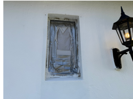
Vindu på bad er blendet igjen
