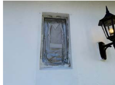
Vindu på bad er blendet igjen
