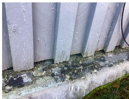
Eksempel på slitasje og sprekker i kledningsbord.
