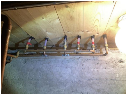
Samlestokk for vannrør i kjeller.
