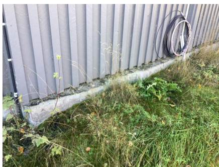
Kledning er inntrukket og avsluttet nært ned mot grunnmur.
