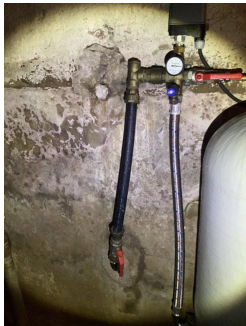
Vanninntak med stoppekran i kjeller.
