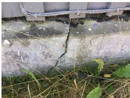
Eksempel på sprekk i grunnmur.
