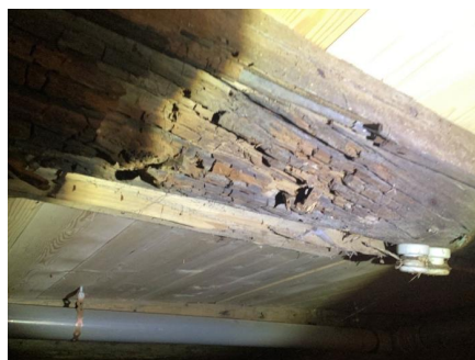
Eksempel på råteskade i bjelke.
