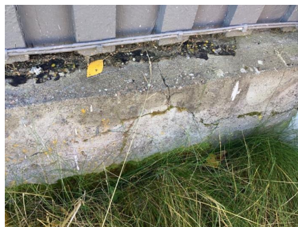
Eksempel på sprekk i grunnmur.
