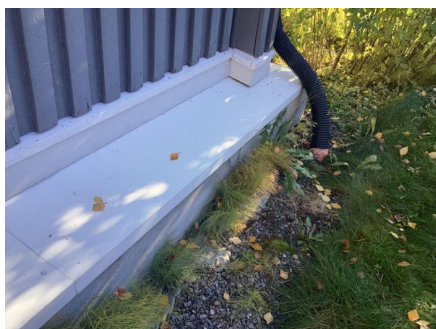
Enkelte deler av grunnmurer er beslått.
