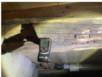
Fuktinnhold i dragere på over 30 vektprosent.
