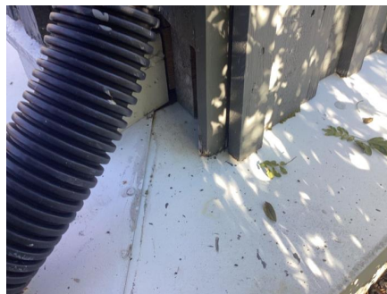
Utett i konstruksjonen på hjørne mot sør-vest.
