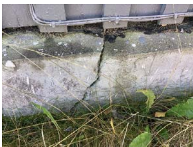
Eksempel på sprekke i grunnmur.
