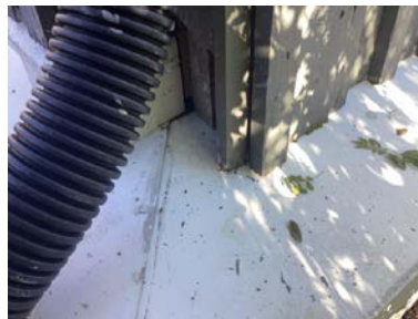
Utett i konstruksjonen på hjørne mot sør-vest.
