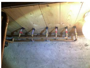
Samlestokk for vannrør i kjeller.
