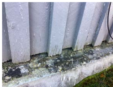
Eksempel på slitasje og sprekker i kledningsbord.
