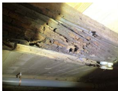
Eksempel på råteskade i bjelke.
