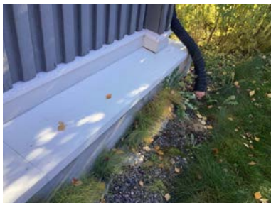
Enkelte deler av grunnmurer er beslått.
