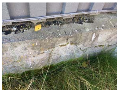
Eksempel på sprekke i grunnmur.
