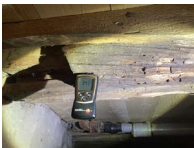
Fuktinnhold i dragere på over 30 vektprosent.
