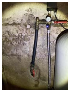
Vanninntak med stoppekran i kjeller.
