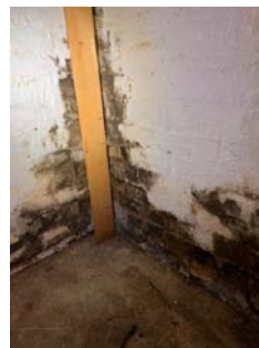
Synlig fukt gjennomgang i grunnmur.
