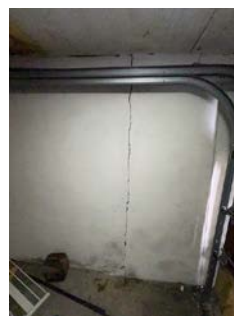
Grunnmur har synlig sprekker enkelte plasser.
