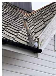
Takstein ligger løst i kant av kilrenne.
