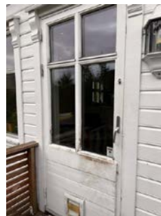
Defekt brystning på balkongdør 1 etg.
