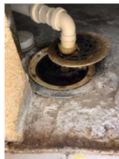
Sluk under badekar og ingen membran er ført ned i sluk.
