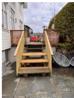
Trapp med forskjellige høyde på trinn og lengde på inntrinn.
