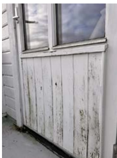
Fukt og råteskader i balkongdør 2 etg.
