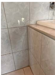
Sprekker i veggfliser rundt kant på badekar.
