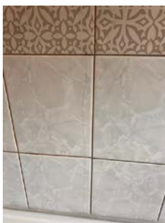
Vertikal sprekk i veggfliser ved badekar.
