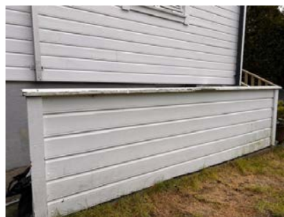
Rekkverk er for lavt.
