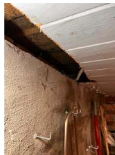
Trepanel mangler på deler av tak i kjeller.
