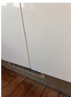
Fuktskade på nedre del av dør under vask.
