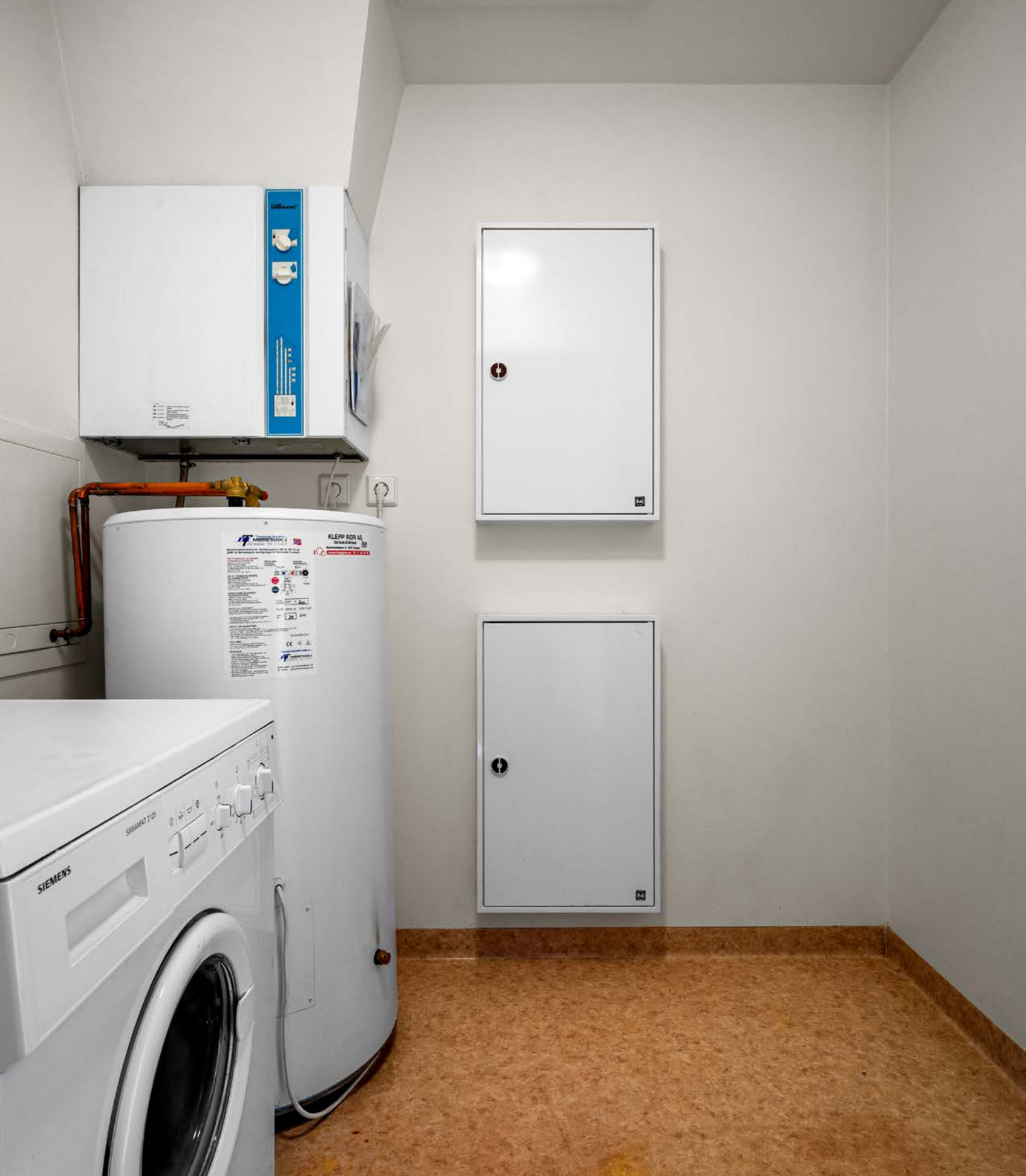
Bod/vaskerom innredet med motor til balansert ventilasjonsanlegg.
