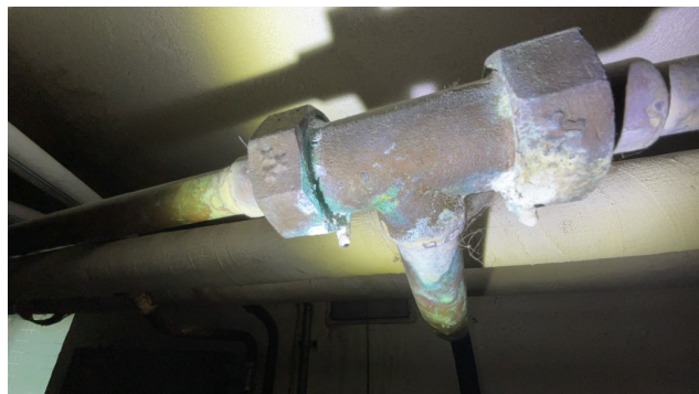
Dråper på eldre rørkoblinger.
