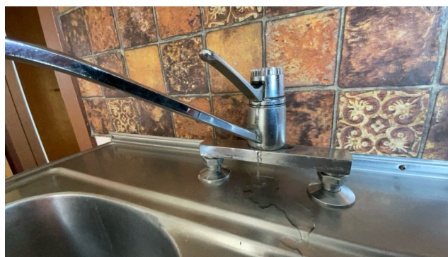
Kjøkkenkran lekker ved tapping
