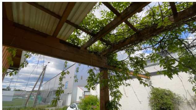
Takplater mangler. Råteforekomster
