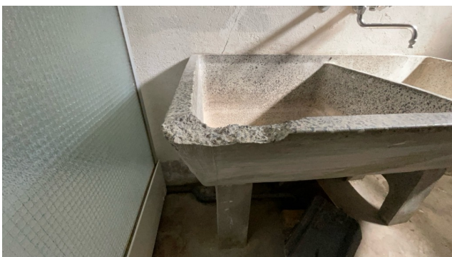
Skade kant vaskekar
