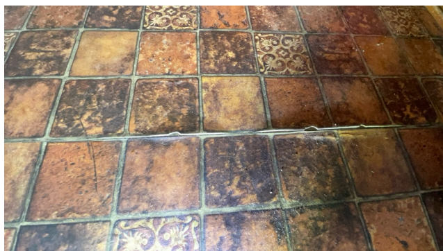
Oppsprekk i belegg.
