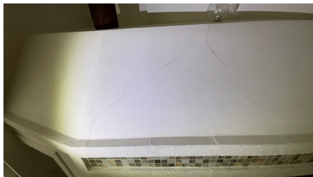
Sprekk i peiskappe
