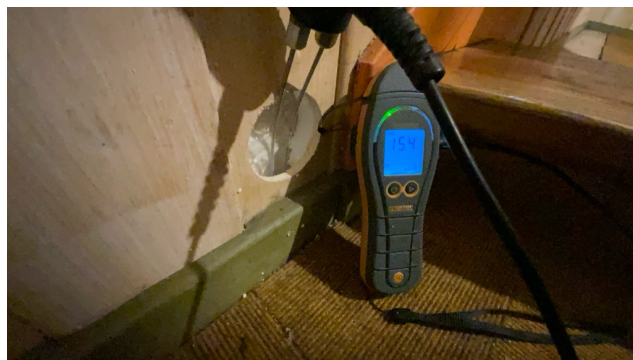
Fuktmåling- ikke direkte skadelig nivå, men over "normalt" for en lukket trekonstruksjon
