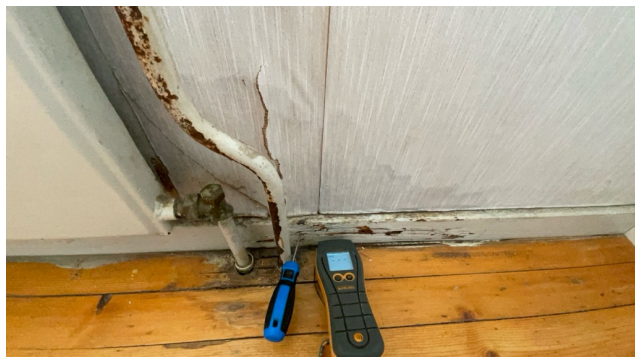
Fuktskade/råte vegg soverom
