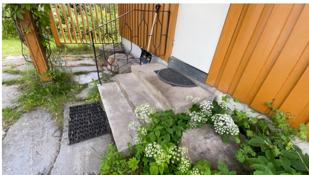
Trapp uten rekkverk på en side (over 50cm høydeforskjell på toppen)
