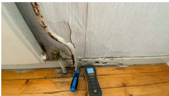
Fuktskade/råte vegg soverom
