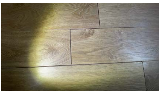
Ufagmessig lagt laminat med oppsprekk
