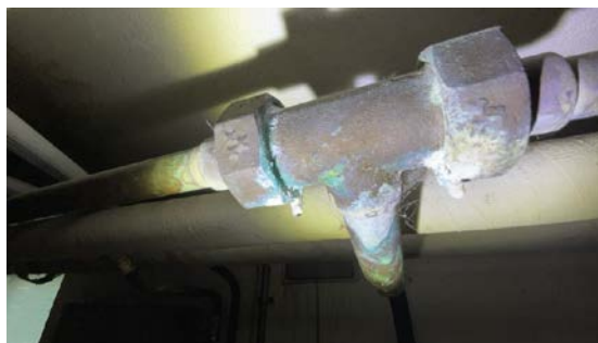
Dråper på eldre rørkoblinger.
