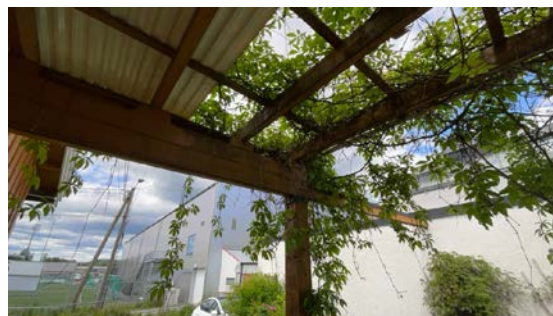
Takplater mangler. Råteforekomster
