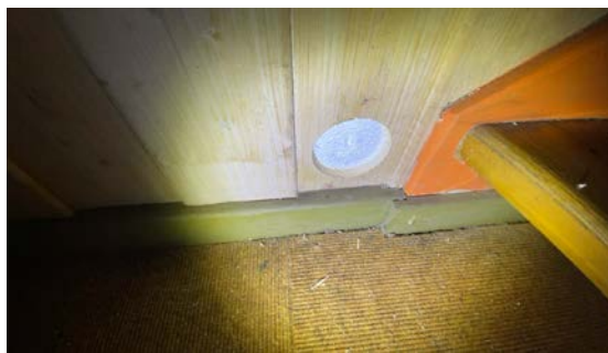
Isolasjon av isopor ikke tillatt idag uten innkledning av brannhemmende materiale
