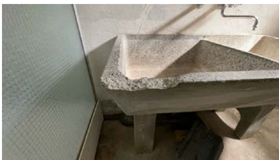
Skade kant vaskekar
