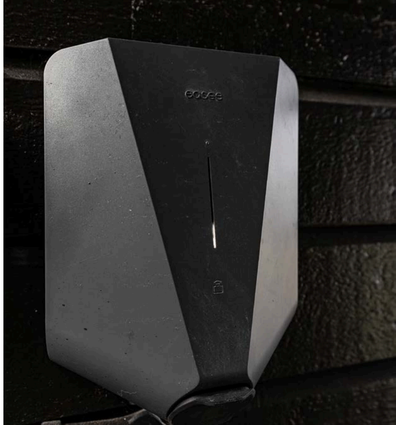
Det ble montert elbil-lader i carporten i 2020.
