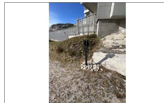
Ladestasjon for elbiler.
