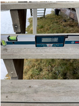
Bildet viser at trappen har noen skjevheter.
