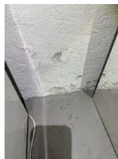
Bildet viser saltutslag på kjellermuren, noe som indikerer fuktinntrengning i konstruksjonen.
