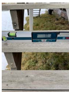
Bildet viser at trappen har noen skjevheter.
