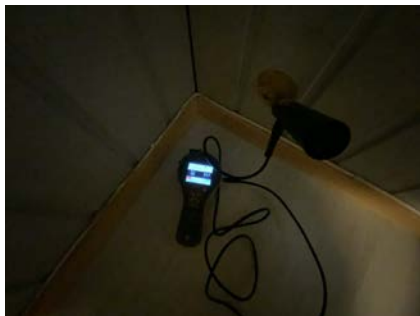
Utført hulltaking. Påvist høy fuktprosent.
