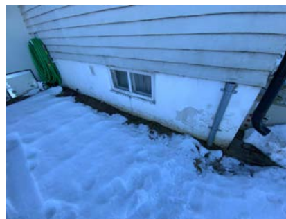
Grunnmuren har sprekkdannelser.
