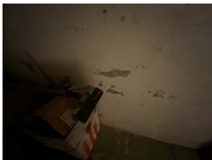
Det er registrert løs puss på muroverflater.
