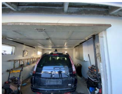
Besiktigelse av garasje. Generell slitasje, elde og behov for vedlikehold.
