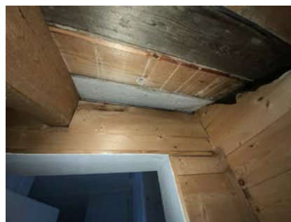
Minimalt med luftespalter på isolert del.
