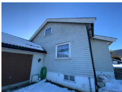
Synlig elde og slitasje samt stedvis råteskader.
