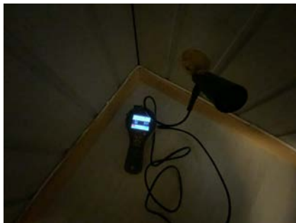
Utført hulltaking. Påvist høy fuktprosent.
