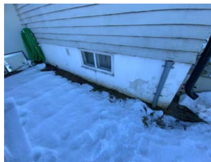
Grunnmuren har sprekkdannelser.
