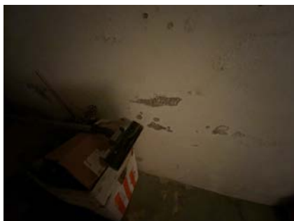
Det er registrert løs puss på muroverflater.
