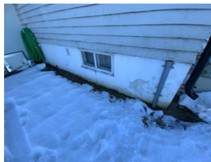
Grunnmuren har sprekkdannelser.
