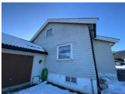
Synlig elde og slitasje samt stedvis råteskader.
