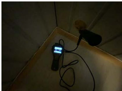
Utført hulltaking. Påvist høy fuktprosent.
