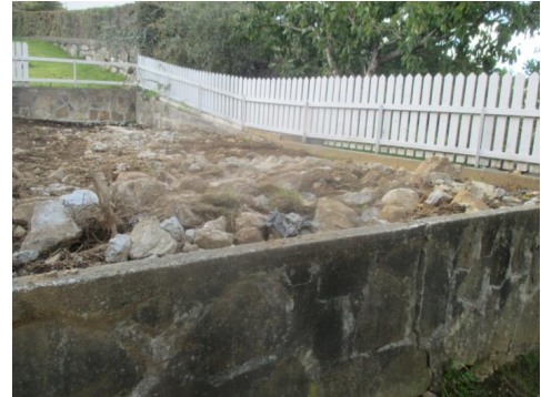
Skulle vært et rekkverk eller annen sikring.
