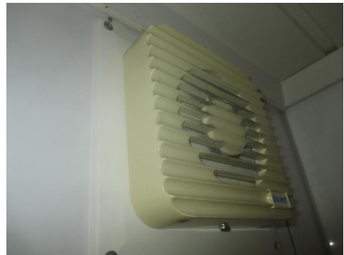
Noe eldre vifte i ytterveggen.
