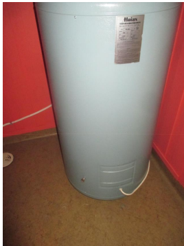
Eldre bereder er plassert på teknisk rom.
