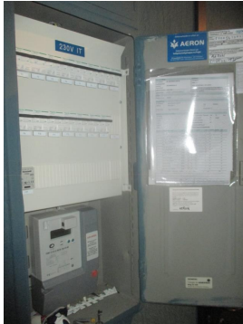
Sikringssskap med nyere innmat.
