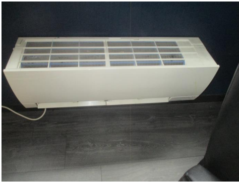
Varmepepumpe i stue.
