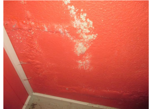
Maling løsner i fra grunnmur.
