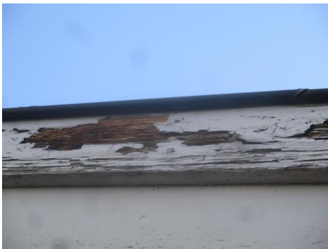
Råteskade på ene vindskien.
