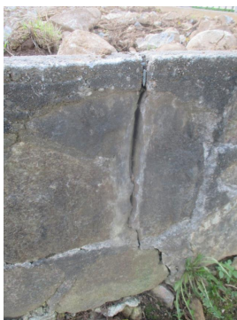
Større sprekke i forstøtningsmur.
