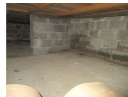
Noe innsig av fuktighet i slike rom til tider må forventes.
