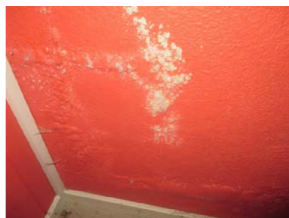
Maling løsner i fra grunnmur.
