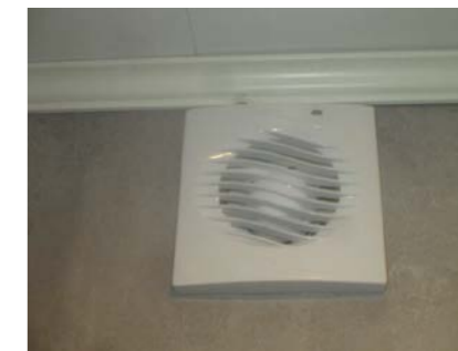
Vifte i ytterveggen.
