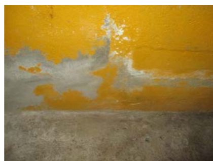
En del fuktvandring ble registrert i nedre del av grunnmur.
