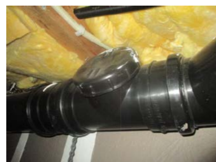
Avløpsrør med stakeluke.
