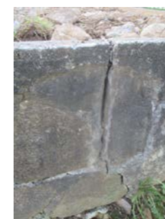
Større sprek i forstøtningsmur.
