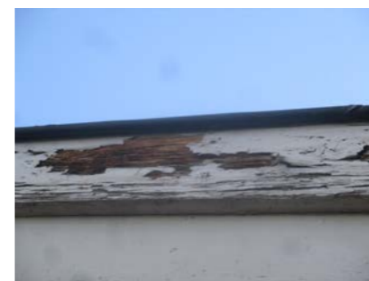
Råteskade på ene vindskien.
