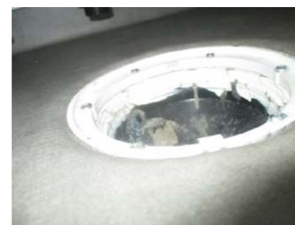
Sluk under innredning.
