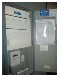
Sikringskap med nyere innmat.
