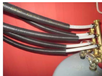
Åpne koblinger uten fordelerskap.
