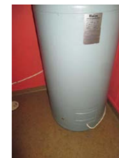
Eldre bereder er plassert på teknisk rom.
