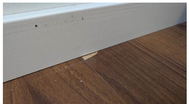
Eksempel på mindre skader / brukslitasje.
