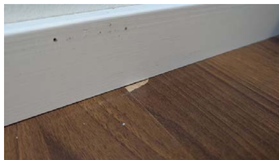
Eksempel på mindre skader / bruksslitasje.
