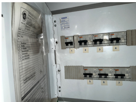
Automatsikringer i sikringsskap plassert i entré.
