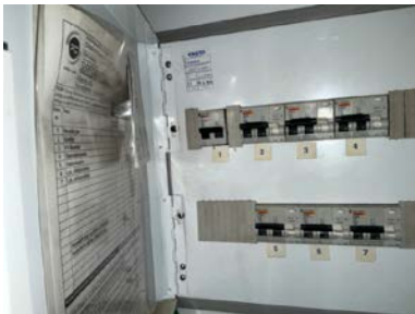
Automatsikringer i sikringsskap plassert i entré.
