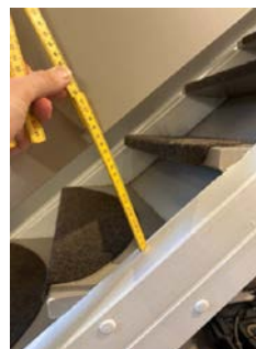
Åpning i rekkverk målt til ca. 16cm
