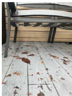
Liten avstand mellom terrasse og bordkledning
