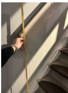
Høyde på topp håndløper er målt til ca 100cm. Det samme gjelder rekkverk med håndløper på den andre siden.
