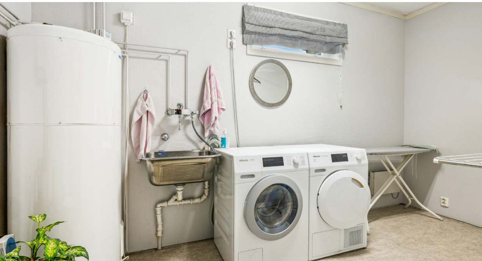
Vaskerom med muligheter og toalett. Ny varmtvannsbereder fra 27.05.25.
