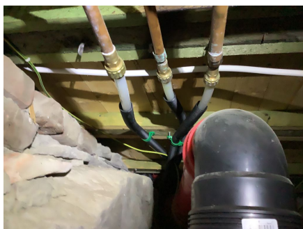
Eventuelt lekkasjevann ledes til rom i kjeller uten sluk.
