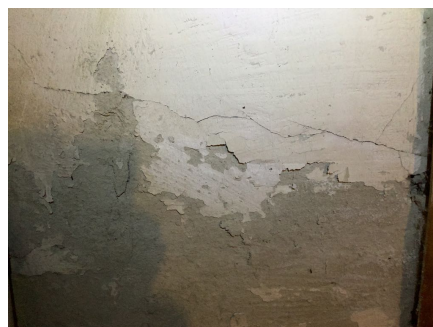
Eksempel på innvendig horisontalriss.
