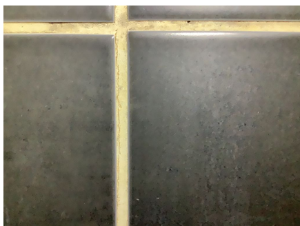
Eksempel på riss i flisfuge i dusjhjørnet.
