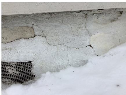
Eksempel på utvendige skråriss.
