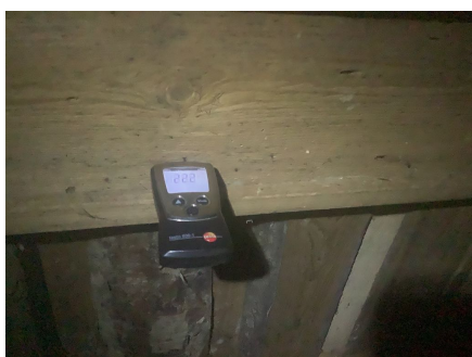
Det måles skadelig fuktnivå i treverk i krypkjeller.
