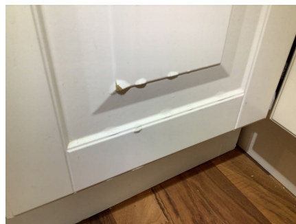
Eksempel på svellskadet front.
