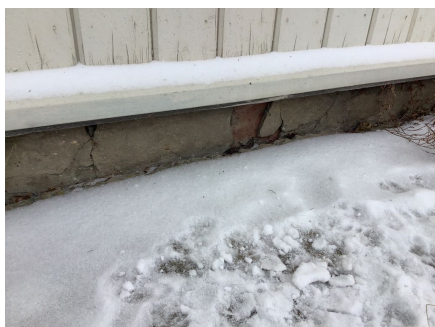
Område med løsnet puss.
