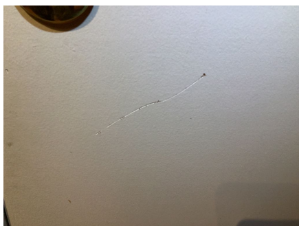
Eksempel på slitasje på dør.
