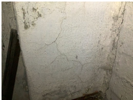
Riss og sprekker i pipe.
