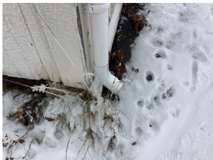
Mangelfull bortledning av takvann.
