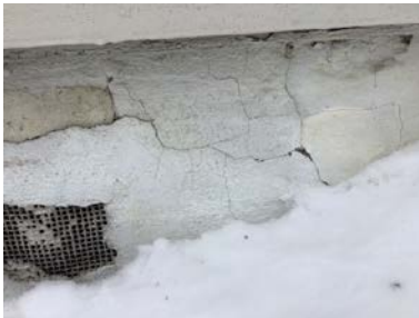
Eksempel på utvendige skråriss.
