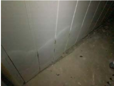
Fuktskadet veggplate på delevegg i kjeller.
