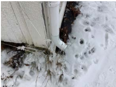
Mangelfull bortledning av takvann.
