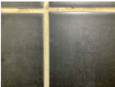
Eksempel på riss i flisfuge i dusjhjørnet.
