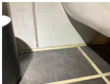
Riss i flisfuge på innkasset toalett.
