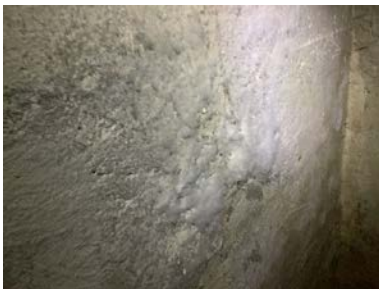
Eksempel på saltutslag.
