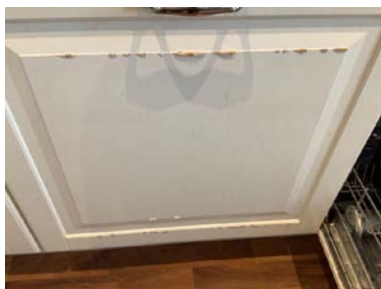
Eksempel på svellskadet front.
