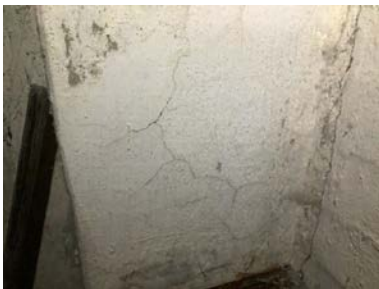
Riss og sprekker i pipe.
