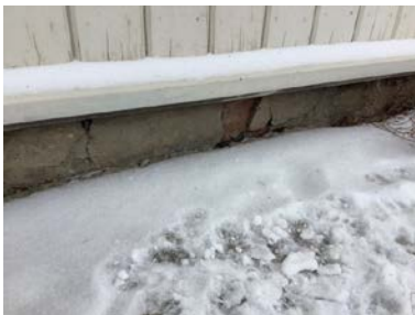
Område med løsnet puss.
