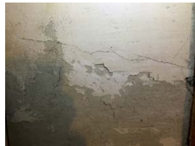
Eksempel på innvendig horisontalriss.
