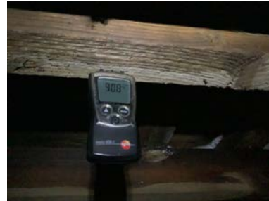
Gulvbjelke måles våt grunnet høy luftfuktighet.
