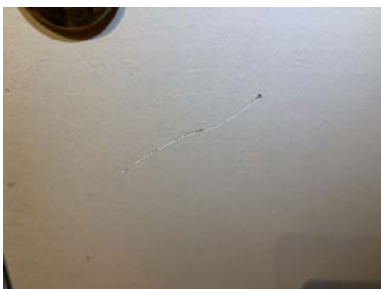
Eksempel på slitasje på dør.
