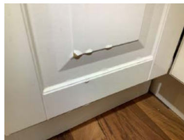
Eksempel på svellskadet front.
