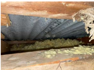
Begrenset lufting på loft.
