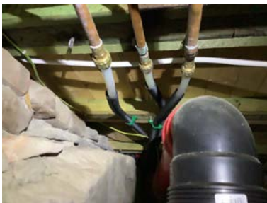
Eventuelt lekkasjevann ledes til rom i kjeller uten sluk.
