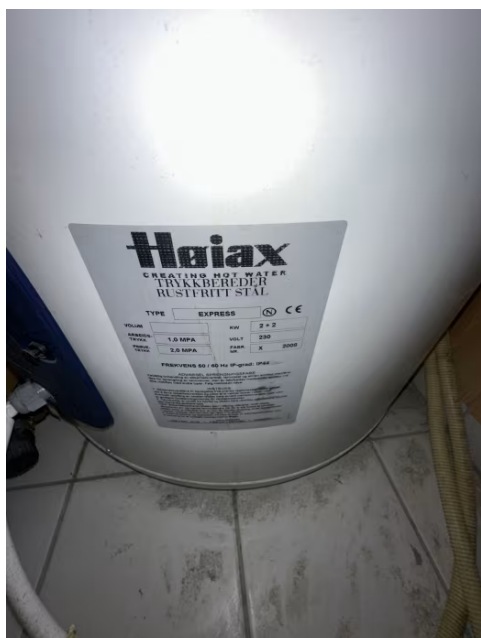
Viser teknisk data på bereder.
