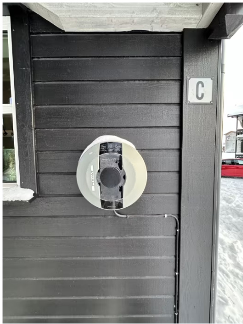
Viser elbillader montert ved inngangsparti.
