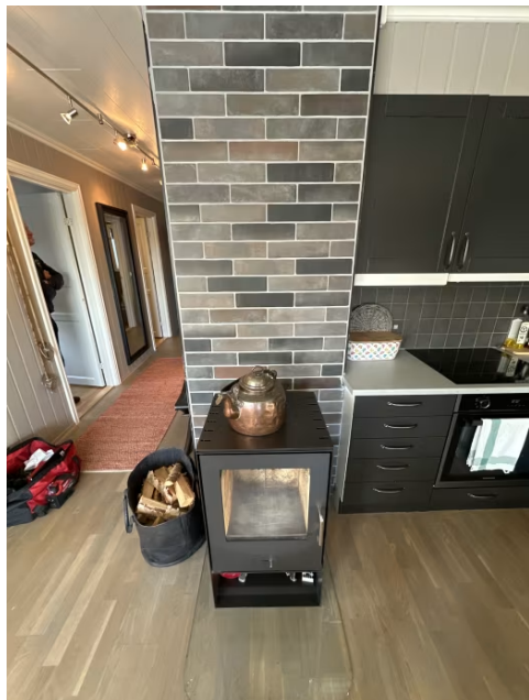
Viser ildsted montert i stue.
