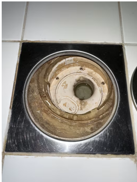
Viser sluk i dusjsonen.
