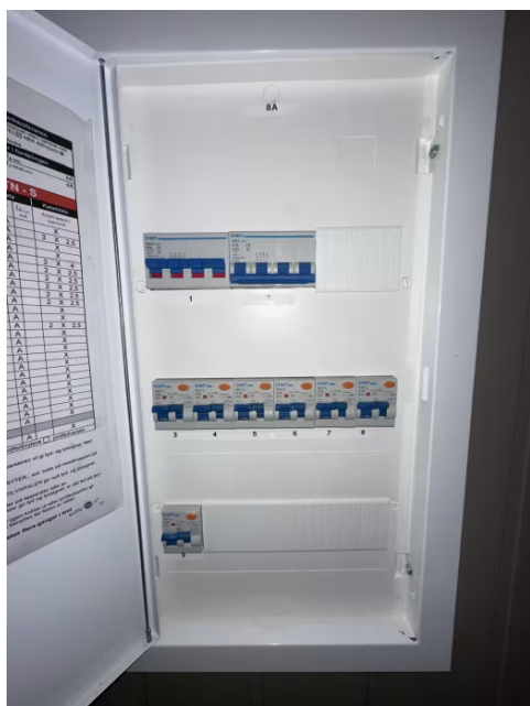
Viser innfelt sikringsskap plassert på soverom.
