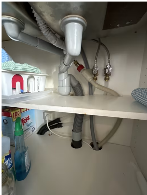
Viser vann og avløpsinnstallasjoner under kum.
