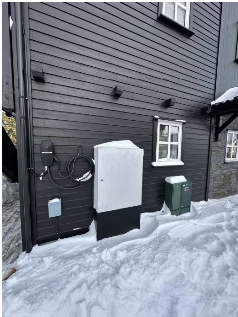
Viser utvendig inntaksskap med måler.
