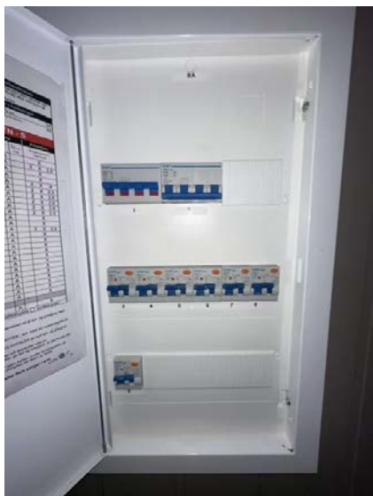
Viser innfelt sikringsskap plassert på soverom.
