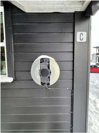
Viser elbillader montert ved inngangsparti.
