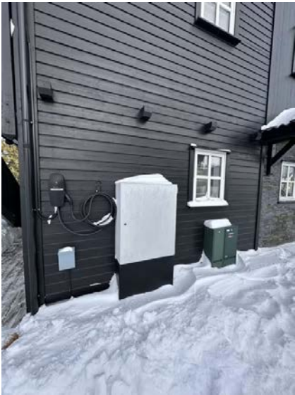
Viser utvendig inntaksskap med måler.
