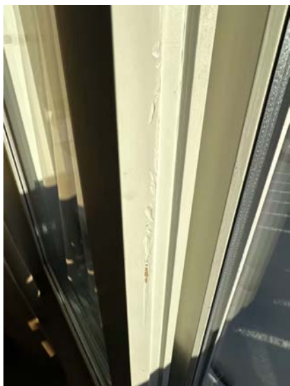
Mindre sår/ hakk i terrassedør. Vedlikehold må påregnes.
