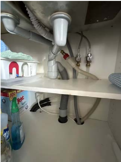
Viser vann og avløpsinnstallasjoner under kum.
