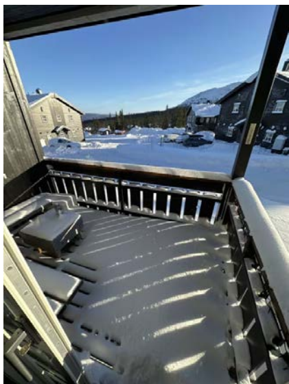
Terrasse mot sør/øst med adkomst fra stue. Terrasse er snødekt og ikke kontrollert.
