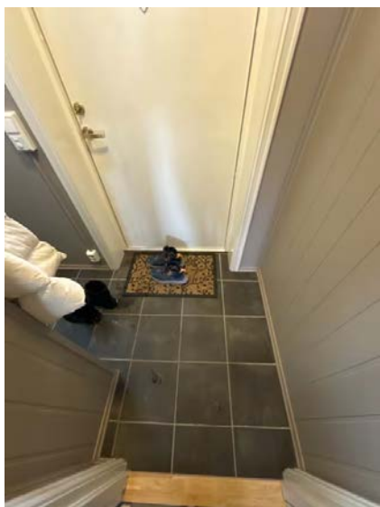
Det ble registrert stedvis «bom» i gulvflis i gang.
