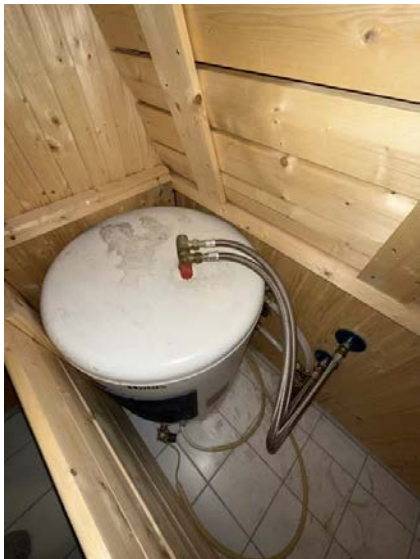
Viser bereder plassert i badstue.
